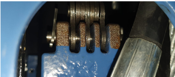
Gleichlaufseil falsch innerhalb der Bühne verlegt
